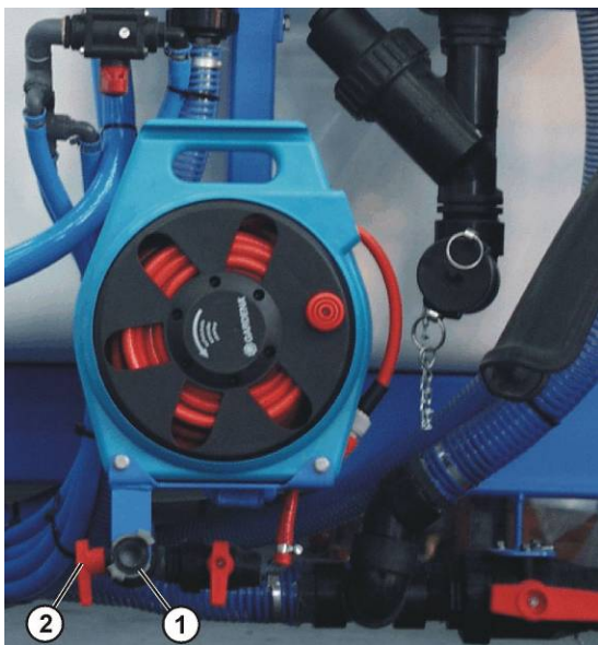
Abb. 9/3 Befüllung des Frischwassertanks mit Hilfe der Schnellkupplung
